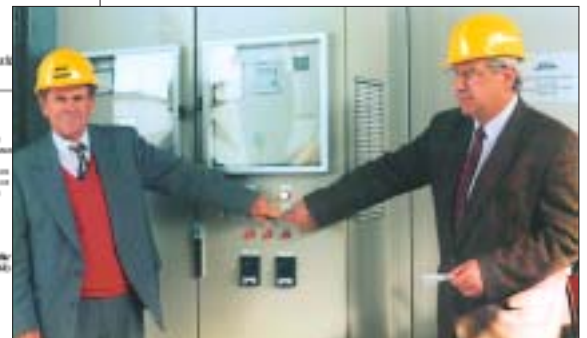
1995: Inbetriebnahme einer neuen Vorreinigungsanlage bei der BASF durch Geschäftsführer Fritz Hoffmann und Verbandsvorsteher Horst Rublack.
